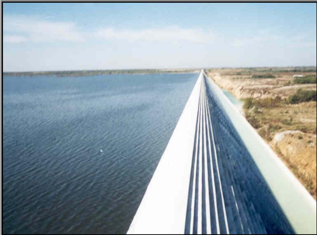
Figura 1.11.- Cimacio de la Presa Derivadora “Las Blancas” en Tamaulipas. (CNA)
