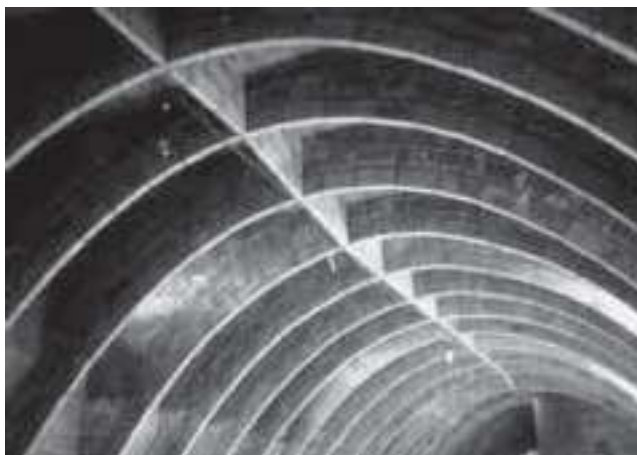
Los arcos deben ser revisados en su totalidad para poder adaptarlos a la nueva situación.
