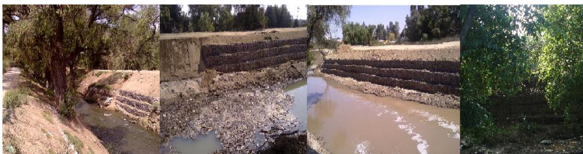
Figura 21. Muros de Gavión. FUENTE. Elaboración propia, 2012.
