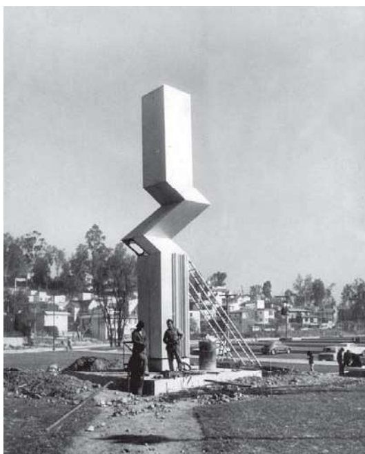
En la construcción de la ESIA Tecamachalco también se contemplaron elementos escultóricos.
