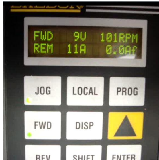
Figura 4-15 Modo remoto. Motor encendido
