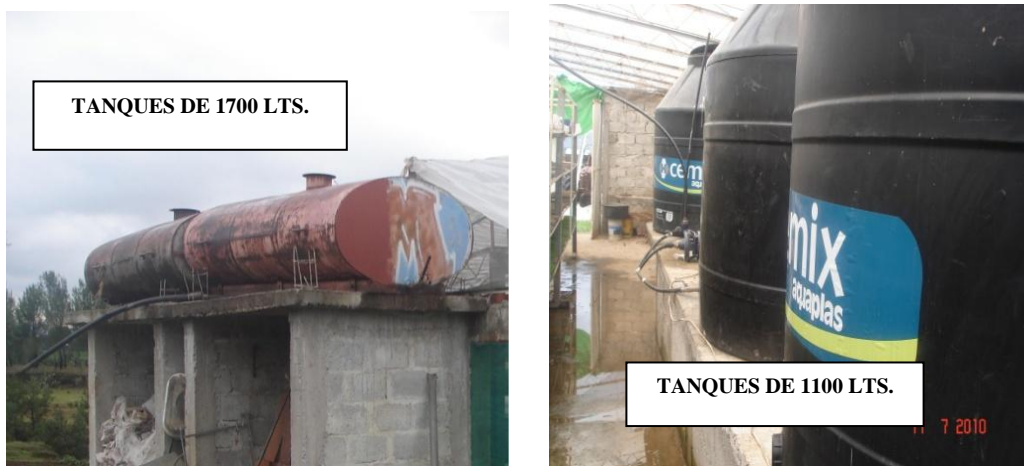
Figura 4.23 Ubicación de los tanques de almacenamiento de agua (Fuente propia)
