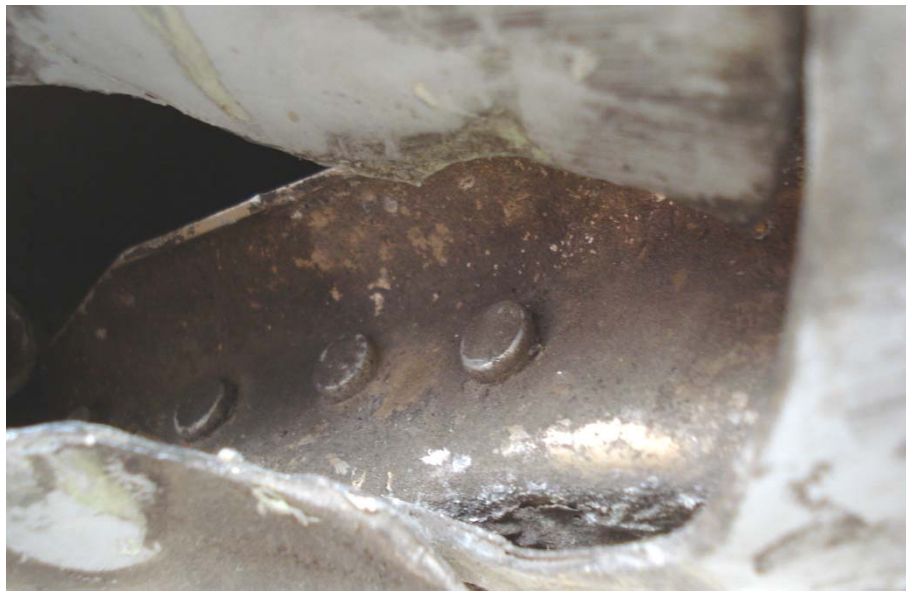
Figura C. Corrosión tipo exfoliación presente en el larguero.
