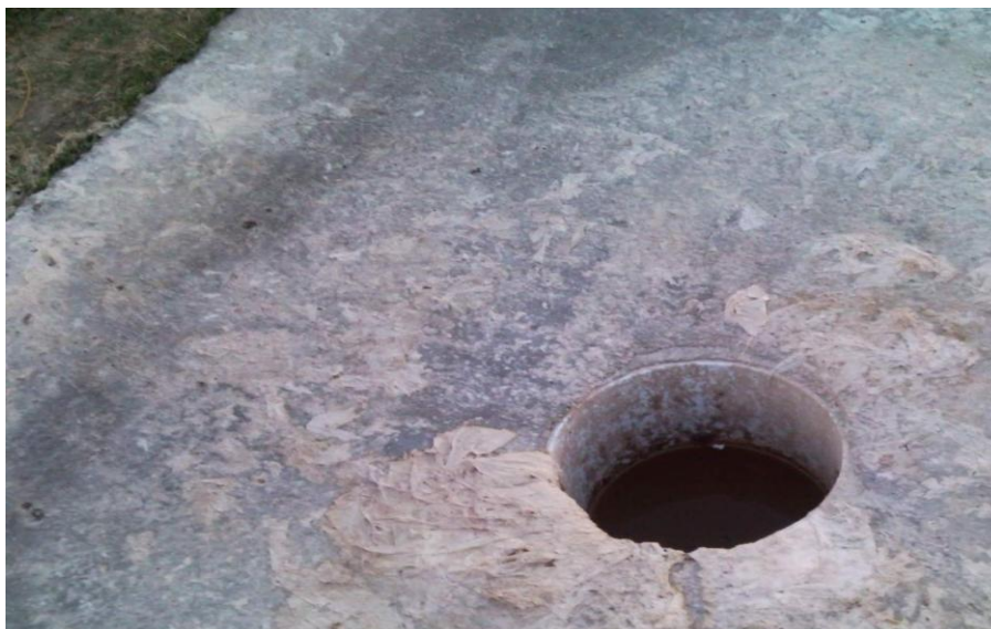
Figura 3.2 Deposito de fosa séptica para aguas azules
