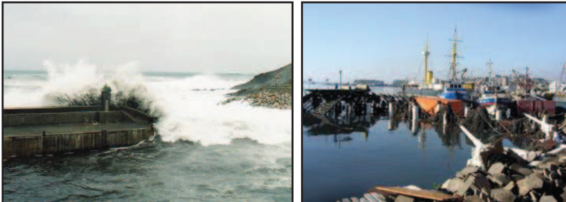
Figura II.6. Agitación en aguas protegidas y daños en instalaciones por el rebase del oleaje extremo.
