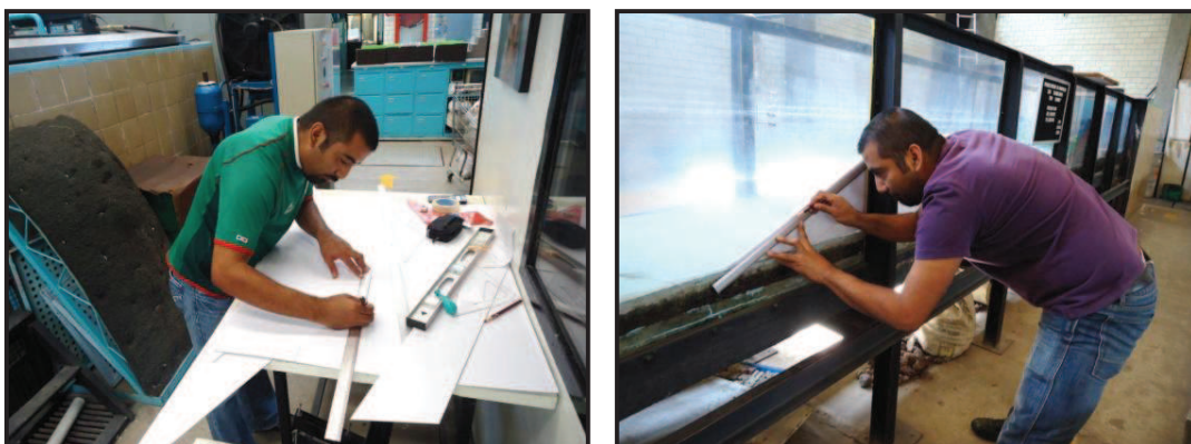
Figura IV.17. Trazo del escantillón para los rompeolas sumergido y trazo en pared de acrílico.
