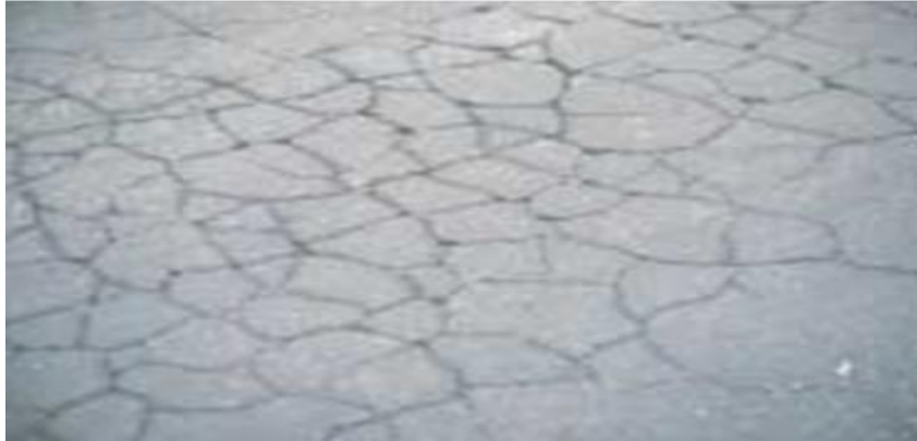
Figura 3. 11 Agrietamiento en malla cerrada.
