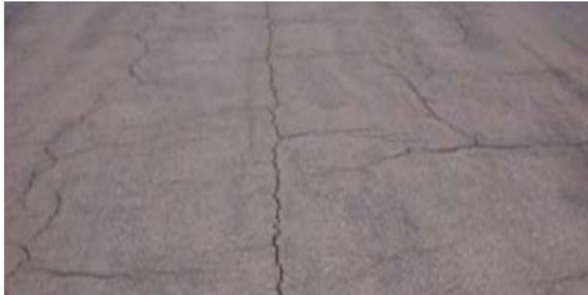
Figura 3. 10 Agrietamiento en retícula.
