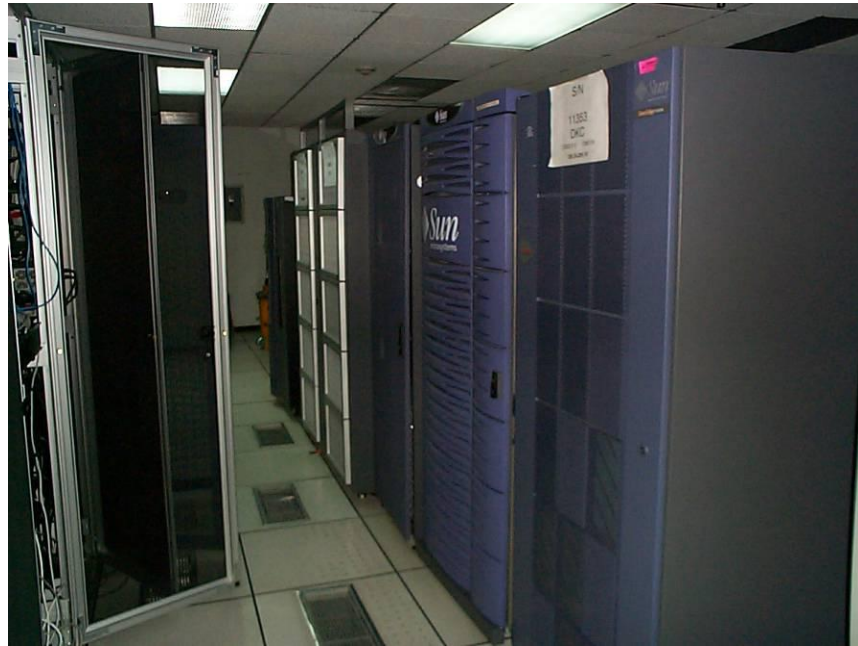
Figura 3.11 SAN de fibra óptica de la SEP. Se observa el arreglo de cajas de almacenamiento.
