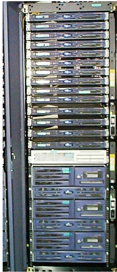
Figura 2.3 Gabinete SUN de 40U. Se observan 14 servidores de 1U, 1 de 2U y 3 de 3U, la consola de control está alojada en otro gabinete. (Fuente Autoría propia)
