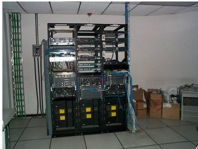
Figura 3.4 Sitio de comunicaciones del Centro de Cómputo Viaducto. (Fuente Autoría propia)
