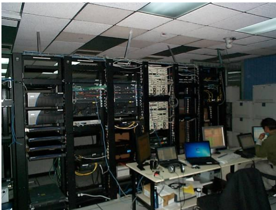
Figura 3.5 Rack de seguridad perimetral de la SEP. (Fuente Autoría propia)
