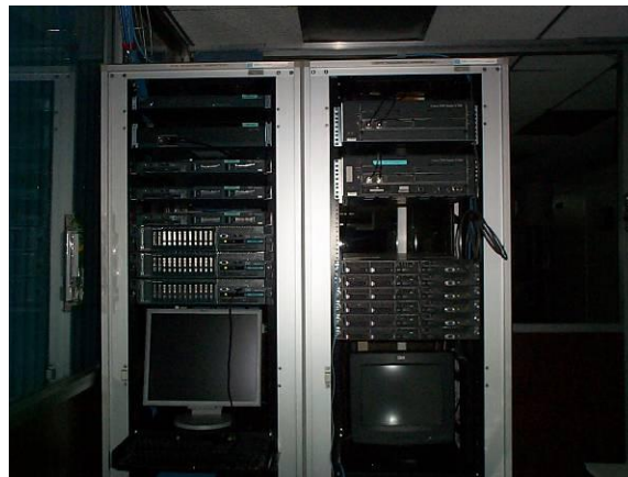
Figura 3.6 Rack de servidores antivirus de la SEP. (Fuente Autoría propia)
