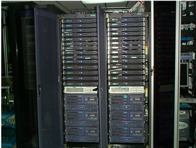
Figura 3.9 Arreglo de servidores de la SEP. (Fuente Autoría propia)
