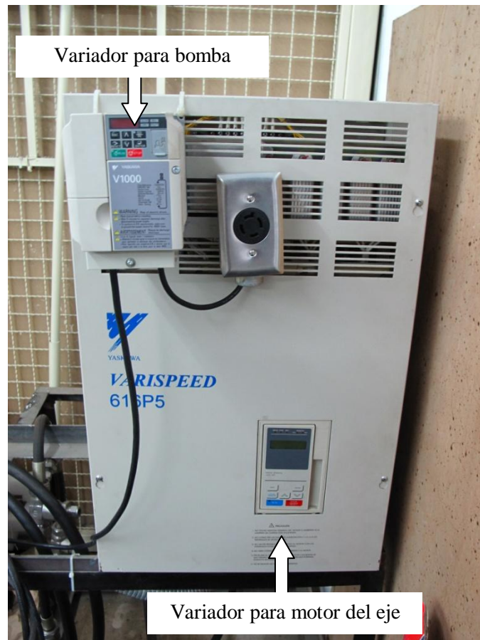
Imagen 5- 1: variador para motor del eje y para bomba hidráulica
