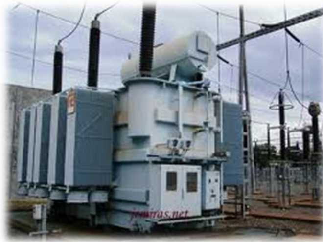
Figura 3.2.- Transformador Eléctrico de Potencia. Fuente. (2011, Elaboración Propia 2011).
