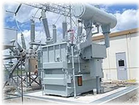
Figura 3.1.- Subestación Eléctrica de Potencia. Fuente. (2011, Elaboración Propia 2011).
