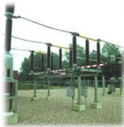
Figura 3.6.- Seccionadores instalados en una Subestación Eléctrica de Potencia. Fuente. (2011, Elaboración Propia 2011).
