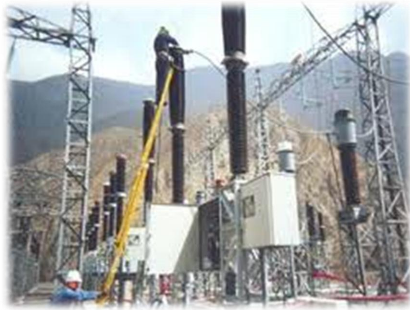
Figura 2.6.- Instalación de una Subestación Eléctrica de Potencia. Fuente.( www.cfe.gob.mx ).
