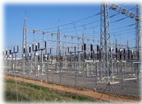
Figura 3.7.- Buses instalados en una Subestación Eléctrica de Potencia. Fuente. (2011, Elaboración Propia 2011).
