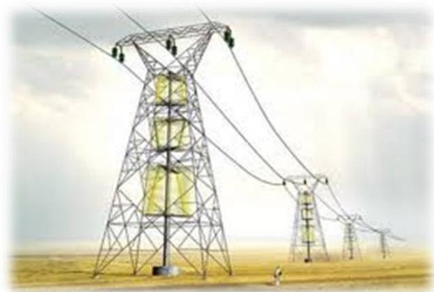
Figura 2.4.- Líneas de Transmisión con Torres de Suspensión.
