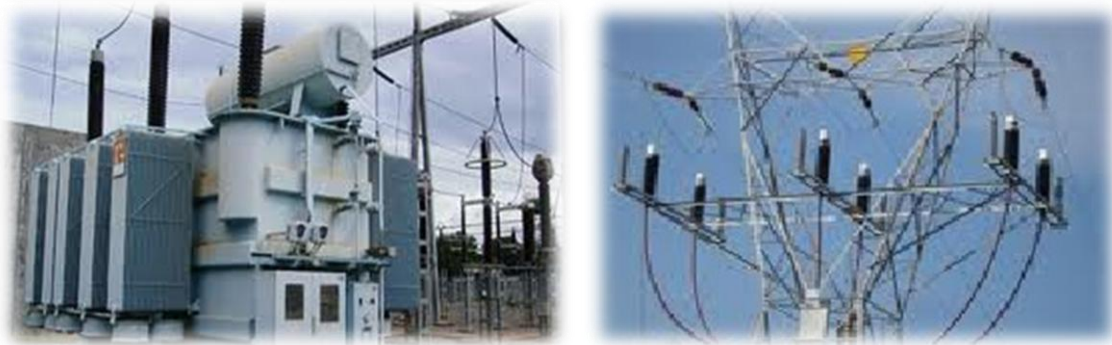
Figura 3.9.- Apartarrayos instaladas en una Subestación Eléctrica de Potencia. Fuente. (2011, Elaboración Propia 2011).
