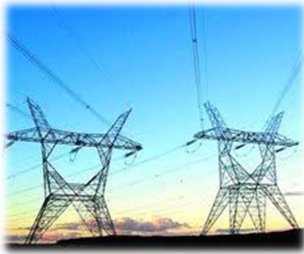
Figura 2.3.- Líneas de Transmisión con Torres de amarre.
