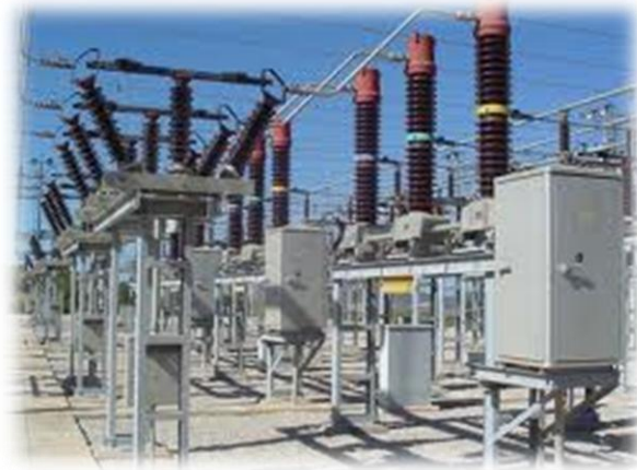
Figura 3.3.- Equipos Eléctricos en una Subestación Eléctrica de Potencia. Fuente. (2011, Elaboración Propia 2011).
