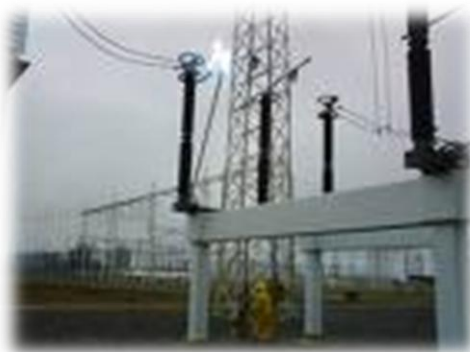
Figura 3.8.- Cuchillas de puesta a tierra instaladas en una Subestación Eléctrica de Potencia. Fuente. (2011, Elaboración Propia 2011).
