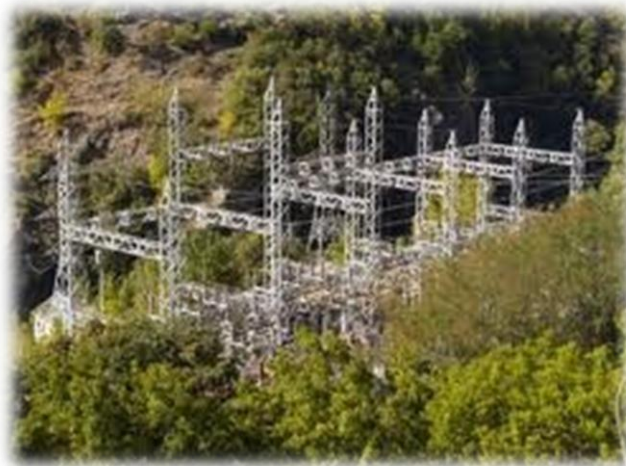
Figura 3.10.- Estructura de Soporte en una Subestación Eléctrica de Potencia. Fuente. (2011, Elaboración Propia 2011).
