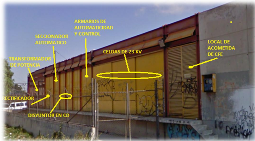
Figura 3.12.- Forma física de una Subestación Eléctrica de Potencia para Rectificación. Fuente: (Google, 2011).
