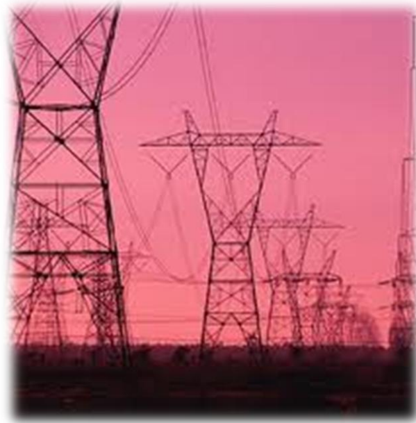
Figura 2.2.- Líneas de Transmisión sobre estructura metálica.
