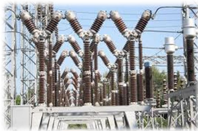
Figura 3.4.- Interruptores de Potencia en una Subestación Eléctrica. Fuente. (2011, Elaboración Propia 2011).
