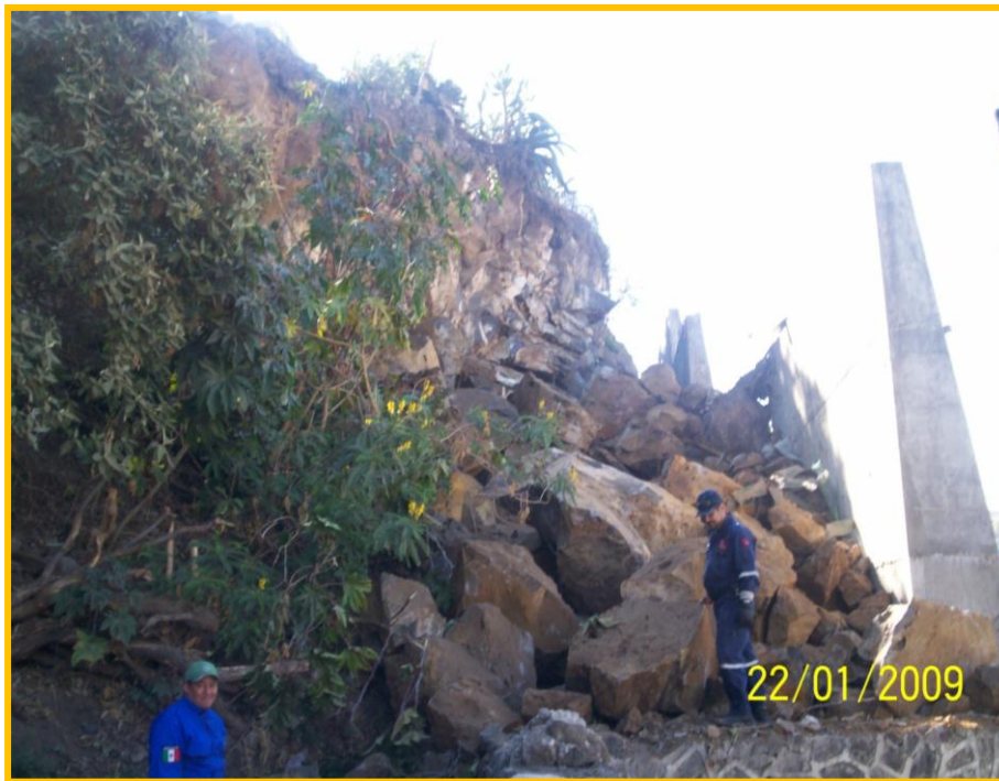
Figura 3.12 Caída de bloques. Fuente: SPC del DF.
