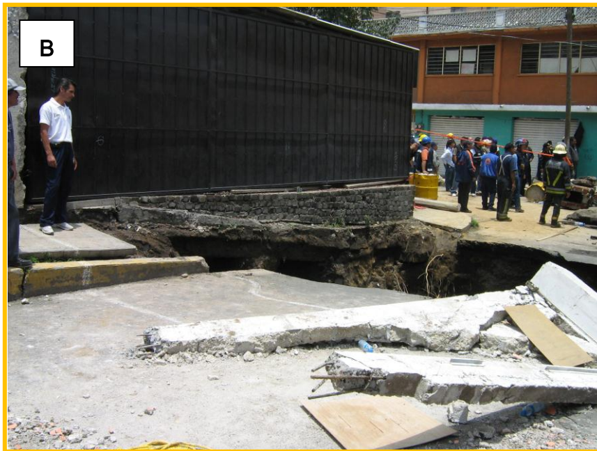
Figura 4.1 Socavación originado la reactivación de una grieta.
