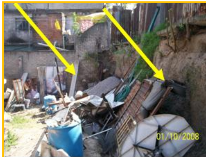
Figura 3.7. Talud de tierra y fragmentos de roca donde se encuentra en estado de riesgo, debido a la posible caída o deslizamiento, debido a la carga y filtraciones de agua.
