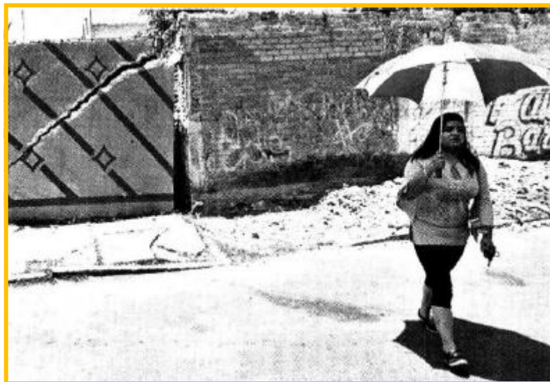
Figura 4.8. Daños estructurales en una fachada. El problema de las grietas de Iztapalapa, se extiende de San Lorenzo cerca de Tláhuac hasta Ermita Zaragoza.
