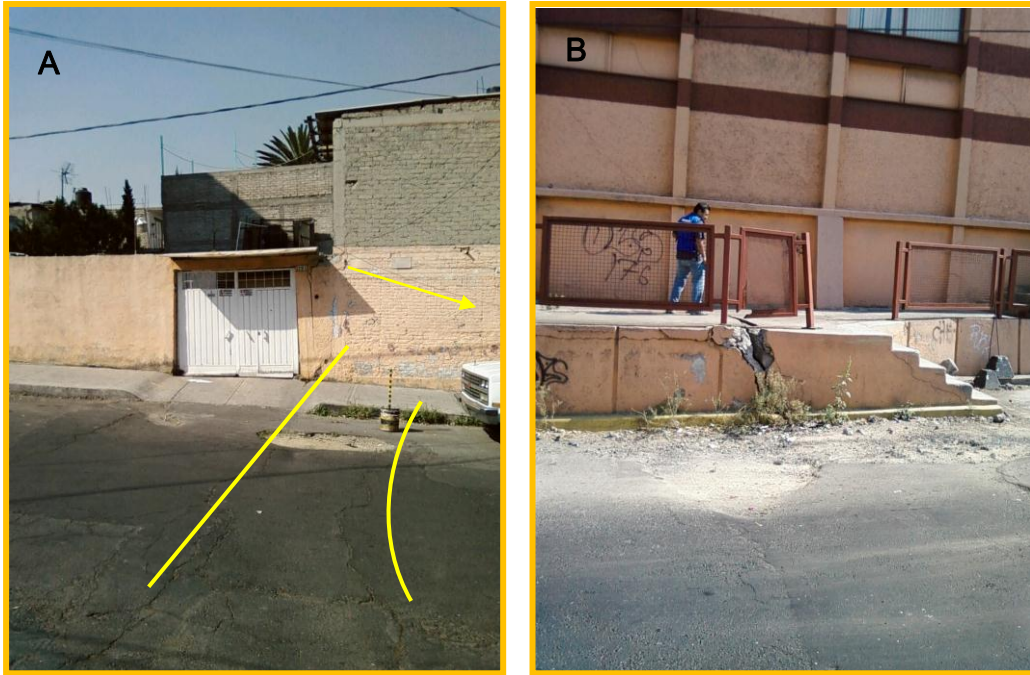
Figura 4.5 A) Vista frontal del predio Liberia No. 291 Colonia Pensador Mexicano y B) Daño estructural en escuela localizada en Avenida del Peñón, a causa del agrietamiento de la zona.
