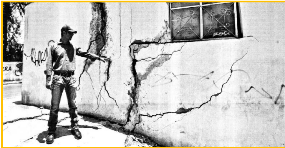
Figura 4.7 Daños estructurales considerados como mayores en una vivienda localizada en la Colonia San Sebastián Tecoloxtitlan, Delegación Iztapalapa.
